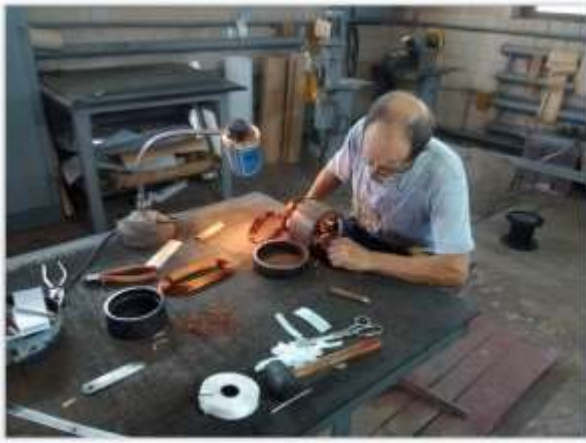
Ліквідація наслідків аварії на НС-1 Суворовської ЗС. Очистка електродвигуна СДН-630 кВт агр. № 1 НС-1 Суворовської ЗС
